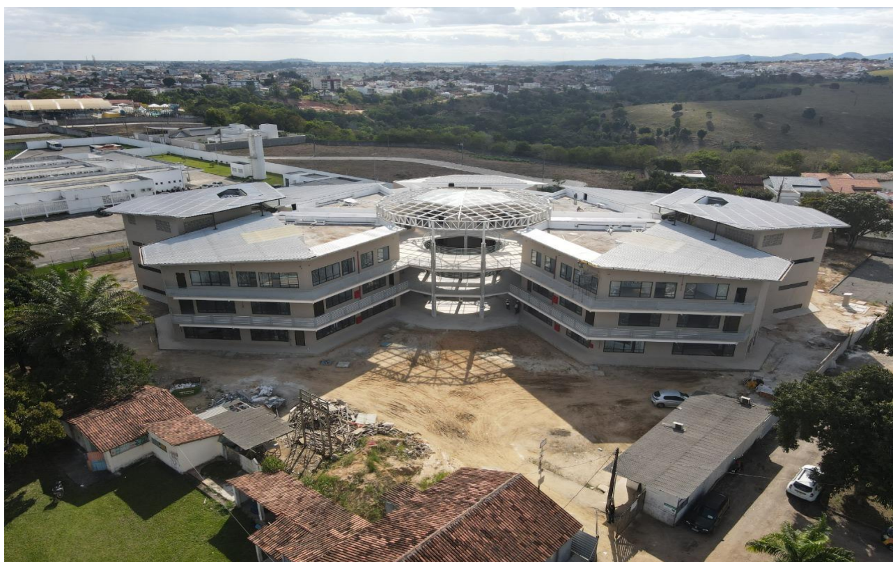
Figura 2: Obra de construção do prédio do Núcleo Pedagógico do Campus Paulo Freire na área do Complexo II.
