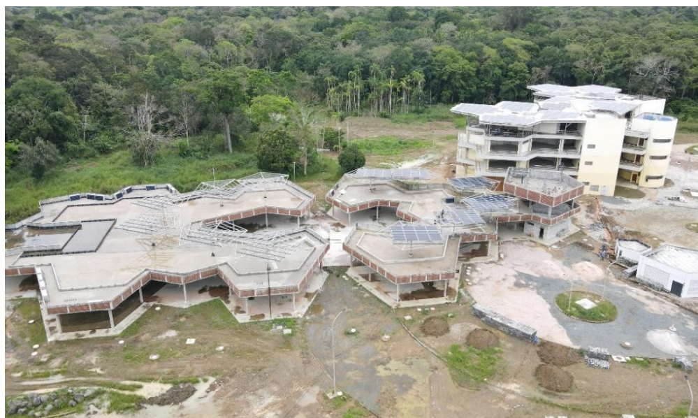
Figura VII.2: Imagem atual das obras do Campus Jorge Amado UFSB. Crédito da foto: Cláudio Souza da Silva (Engenheiro Civil – DINFRA/PROPA, 2021).
